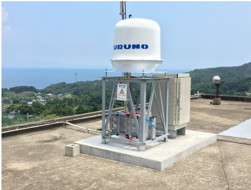
図2 レーダーの設置状況。鹿児島県立錦江湾高等学校に設置。
