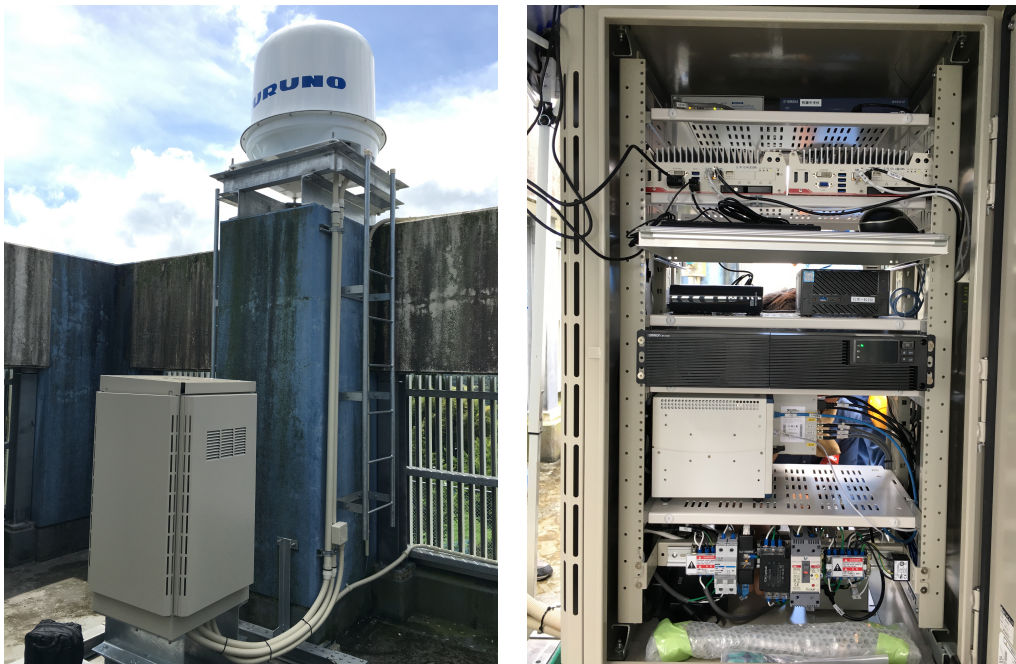
図3 レーダーの設置状況。霧島市立牧園中学校に設置。
